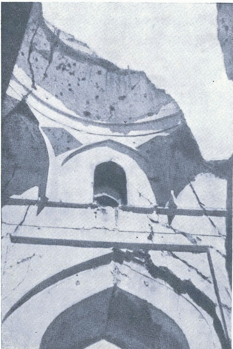
Рис. 34. Деформация парусов и свода.
